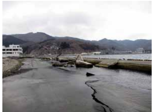
岸壁付近の陥没
