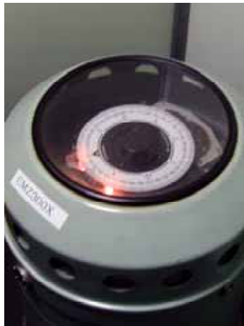
ジャイロコンパス本体 (機器室)
